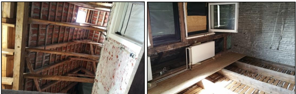
Abb. 2 und 3: Ansichten aus dem Schadensbereich nach Rückbau der Sekundärquellen
